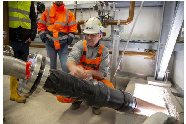
Se instaló un sistema de detección de fugas en el espacio anular de la sala de bombas (exterior).
