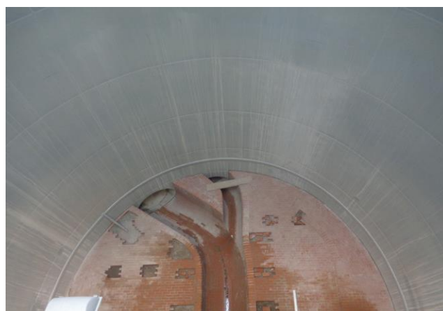
Sure-Grip® PE cinza já montado em uma das três estações de bombeamento subterrâneas.
