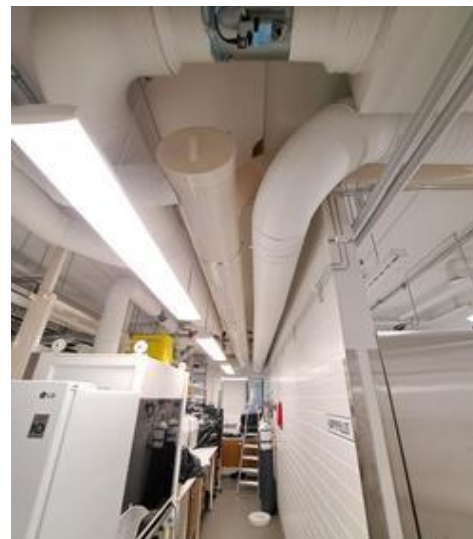
Tubería ECTFE instalada en el laboratorio
