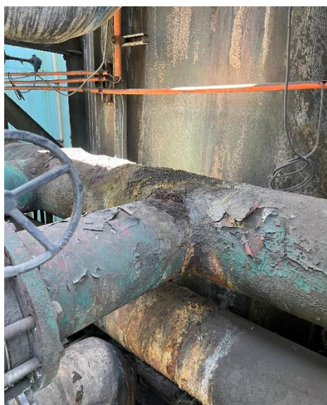
Línea de acero al carbono completamente corroída.
