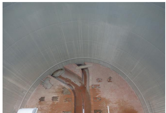
Agru HDPE Sure-Grip® de color gris ya montado en una de las tres estaciones de bombeo subterráneas.
