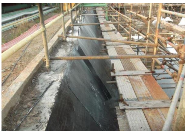
Aplicação do revestimento Sure Grip PP preto liso 3mm nas paredes das bacias de rejeito.
