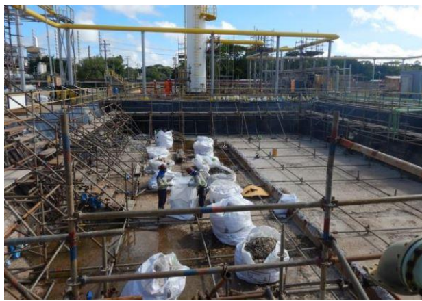
Paredes das bacias de rejeito revestidas e iniciando o revestimento do piso.
