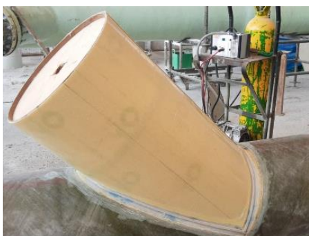
Y-Tee parte de la chimenea
