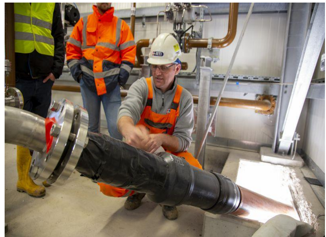
Foi instalado um sistema de detecção de vazamentos entre o tubo principal (interno) e o contenção (externo).
